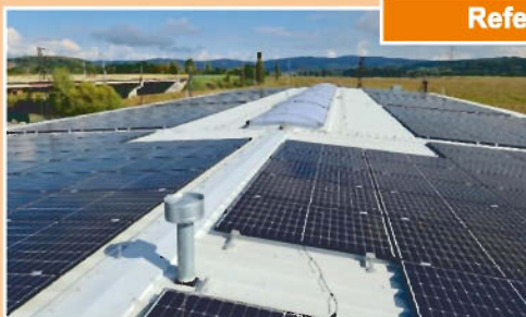
OM Protivín 100 kWp
